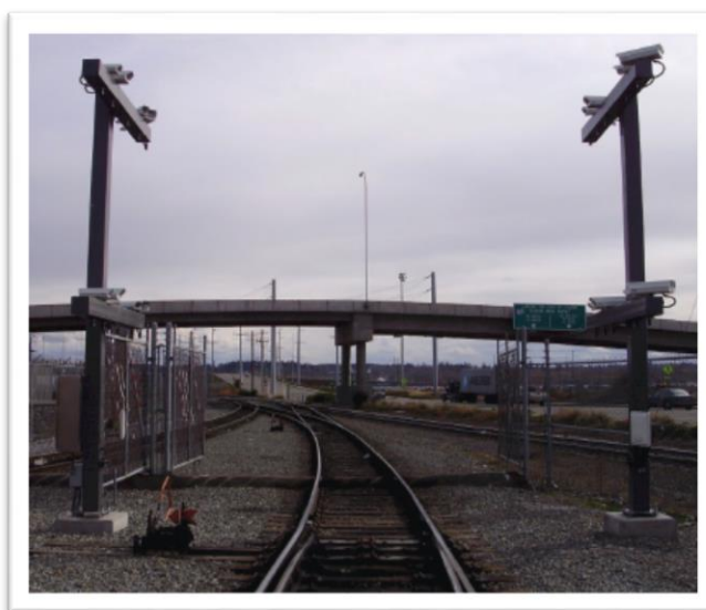
รูปที่ 3-16: รูปการติดตั้งกล้องระบบ Rail OCR ที่บริเวณเครนหน้าท่า (2)
